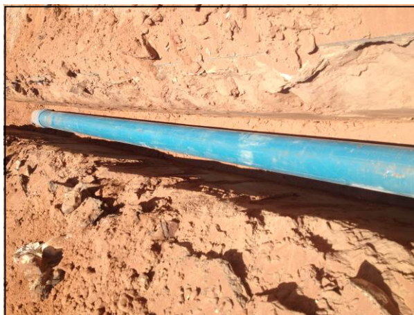
Figura 18 – Adutora de Água Tratada
