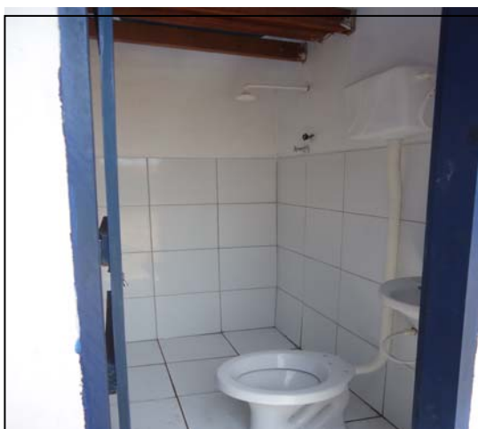
Figura 7 - Parte interna da unidade sanitária domiciliar
