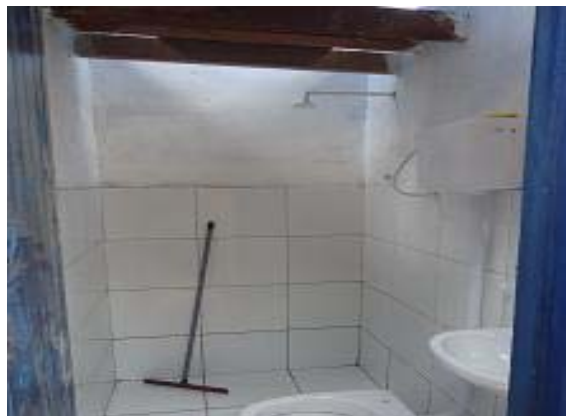
Figura 9 - Parte interna da unidade sanitária domiciliar
