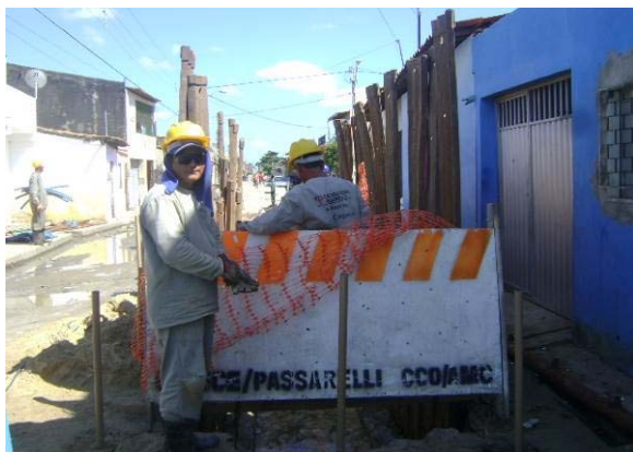
Figura 21 - Rede Coletora de Esgoto
